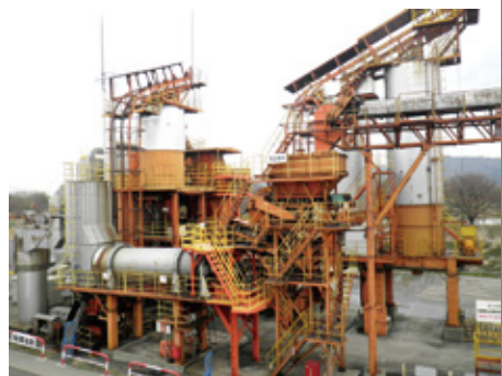
これがアスファルト混合物を製造する施設です!
